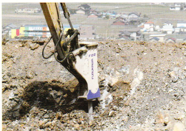
市街地の中にある碎石場で稼働するF22 SS-box
